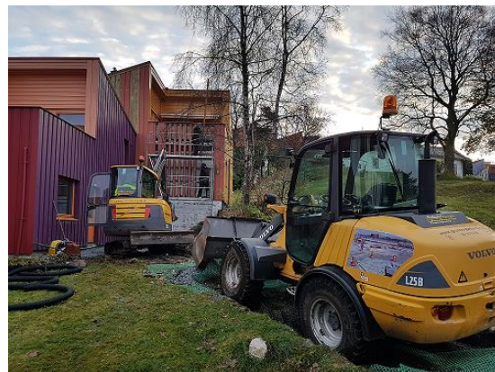
Det blir effektivt når grunnarbeid og bytte av dårlige materialer blir gjort samtidig.
